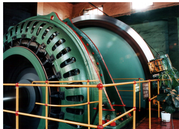
Fot. 6. Maszyna wyciągowa kop. Mysłowice
