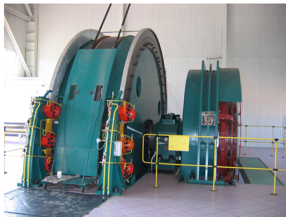
Fot. 8. Maszyna wyciągowa kop. Budryk szyb VI
